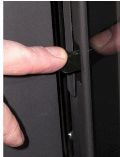
Abb. 6: Öffnen der Eck-Feuerungstür links zur Reinigung
